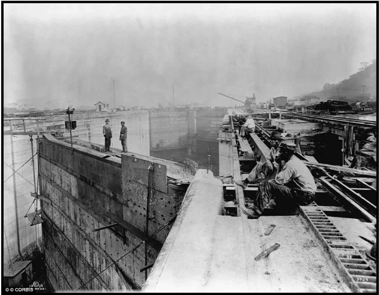
OBSERVEN LAS DOS PERSONAS EN LAS COMPUERTAS NO TERMINADAS AÚN OBSERVE THE TWO WORKERS ON THE LOCK GATES NOT YET COMPLETED
